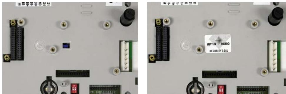
Abbildung 2-63: W1-Millivolt-Drahtbrücke – Unversiegelt (links) und versiegelt (rechts)
