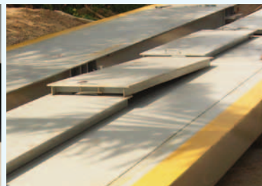
Les plaques d'accès aisément amovibles facilitent la maintenance
