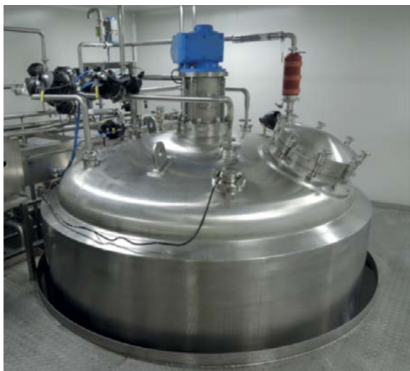
Horní část reaktoru prostupující do dalšího podlaží s dostatečnou prostorovou rezervou k pohybu
