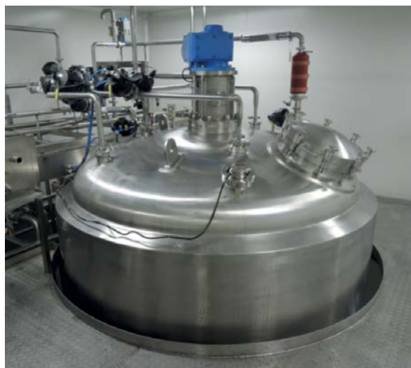
Sezione superiore del reattore che si estende al piano successivo con uno spazio di movimento adeguato
