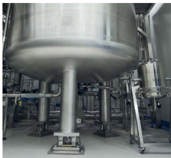
Sezione inferiore del reattore installato sui moduli di pesatura a compressione flessibile
