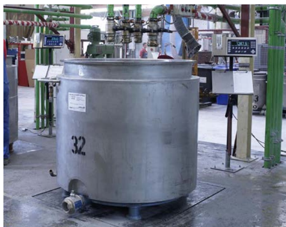
Serbatoio con le tubazioni scollegate
