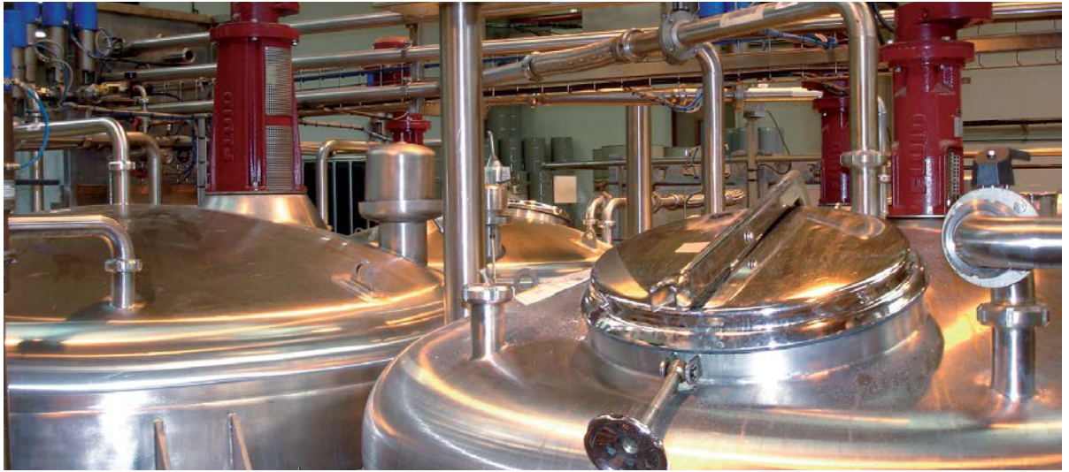
複数のパイプが接続されたタンク
