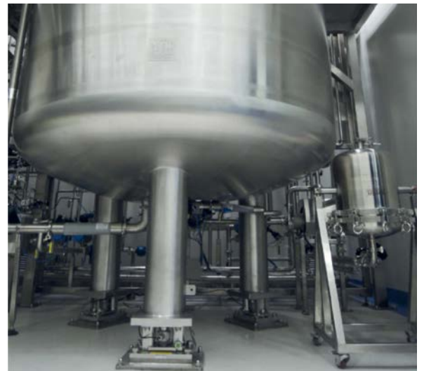
柔軟性の高い圧縮計量モジュールへ設置されたリアクタの下部
