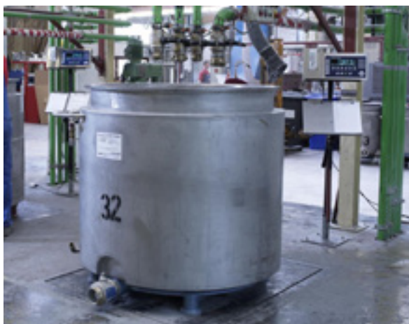
Zbiornik z nieprzyłączonymi rurami
