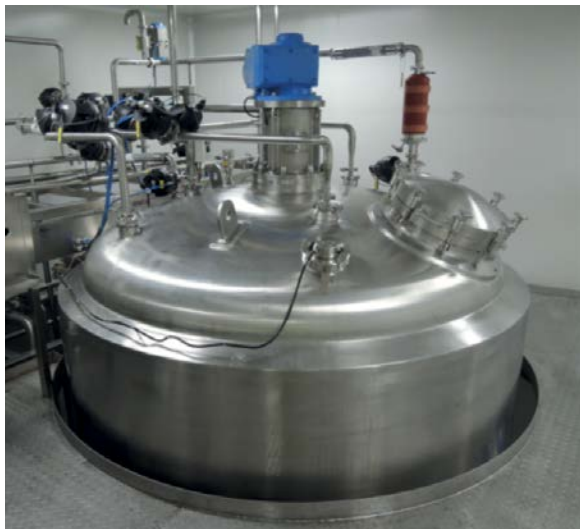
Phần trên của lò phản ứng mở rộng thông qua tầng kế tiếp với không gian đủ cho di chuyển
