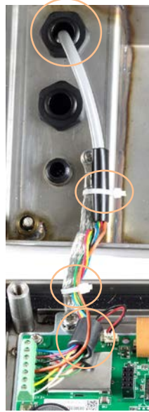
Figure 2-28 : Broche de masse du capteur analogique et installation de la ferrite, IND236
