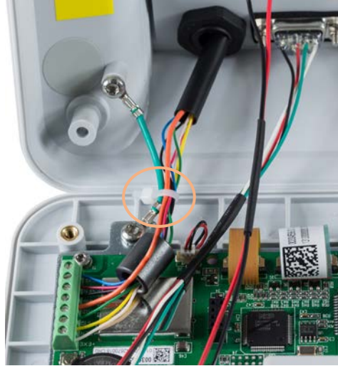
Figure 2-24 : Broche de masse du capteur analogique et installation de la ferrite, IND231
