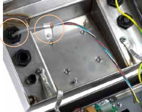
Figure 2-27 : Câble du capteur pénétrant dans l'enceinte de l'IND236 avec le serre-câble de mise à la masse sur le châssis
