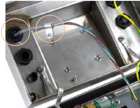
Figura 2-27: Cable de la celda de carga entrando en la caja del IND236, con pinza de conexión a tierra del chasis
