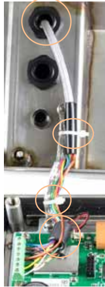
Figura 2-24: Installazione del terminale di messa a terra e della ferrite per la cella di carico analogica, IND236
