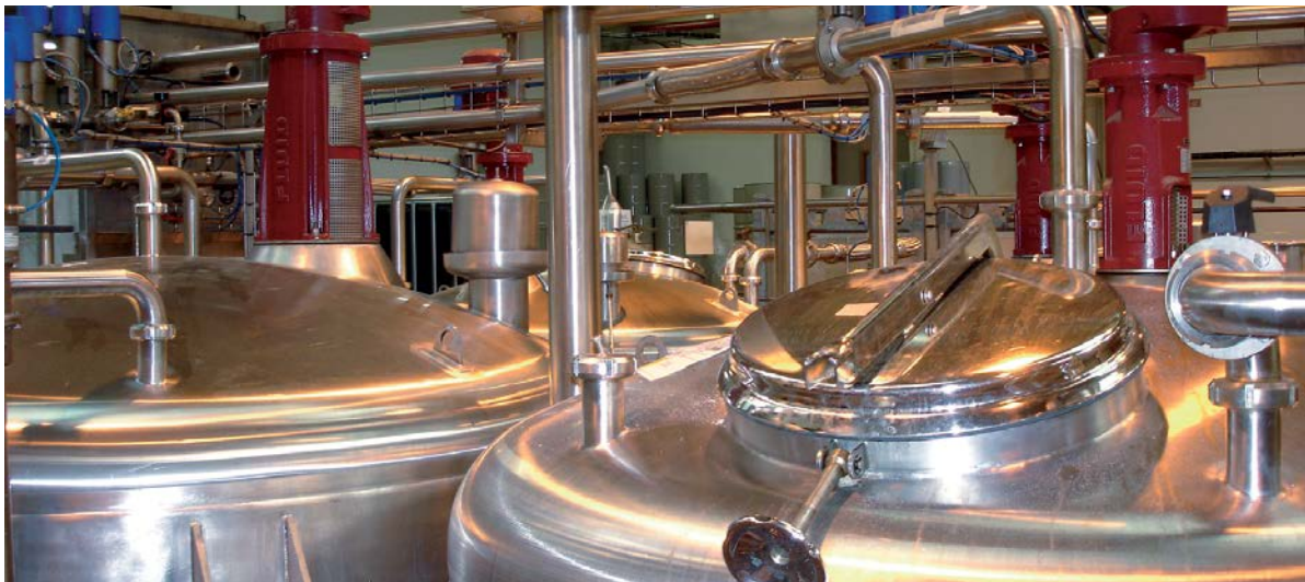
Tanques com vários tubos afixados
