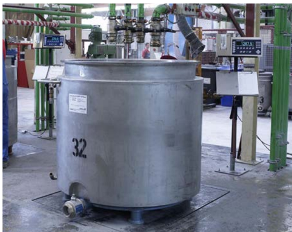
Tanque com tubos não afixados
