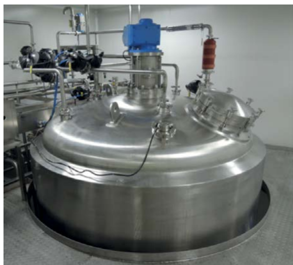
A seção superior do reator que se estende através do próximo piso com espaço adequado para movimentação
