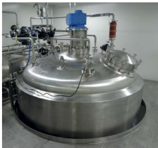
Partie supérieure du réacteur dépassant par le plancher supérieur avec un espace suffisant pour bouger
