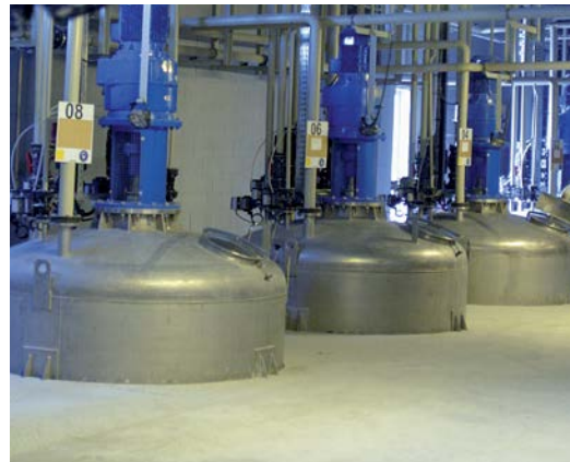
Illustration 2 : Système de pesage de cuves dépassant du sol
