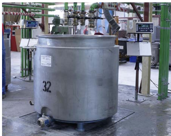
Cuve avec les tuyaux non fixés
